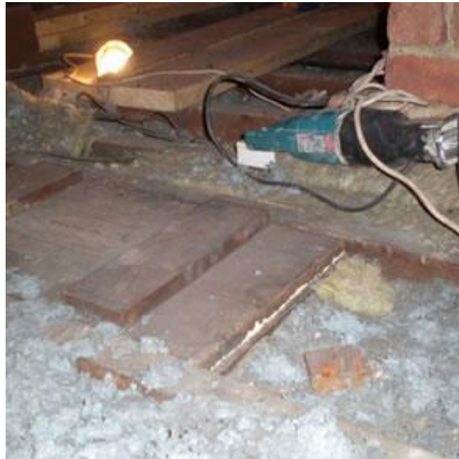
Loose fill asbestos fibres
