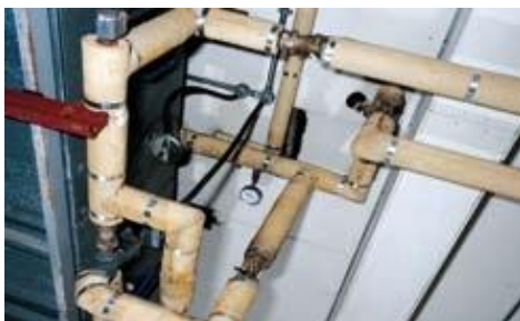
Asbestos pipe lagging
